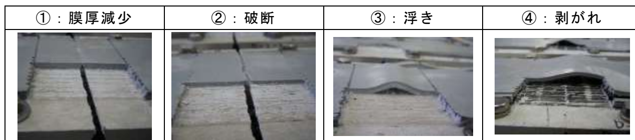
写真 2.5 代表的な①膜厚減少②破断③浮き④剥がれの現象
